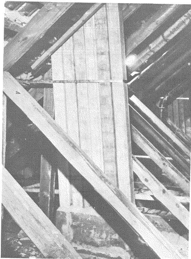
Fig. 12. Aftrækskolonne af eternitkanaler for hætte-system. Kanalerne burde være isolerede. Der vil løbe kondensvand ned gennem dem, så loftet i køkkenerne bliver skjoldede og skal hvidtes hver sommer. Air shafts made of asbestos-cement tubes for a hood system. The tubes should have been insulated. Condensed water will flow down the tubes, so that kitchen ceilings will be discoloured and will have to be whitewashed every summer.
